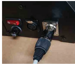
LAN Cable (Ethernet)
